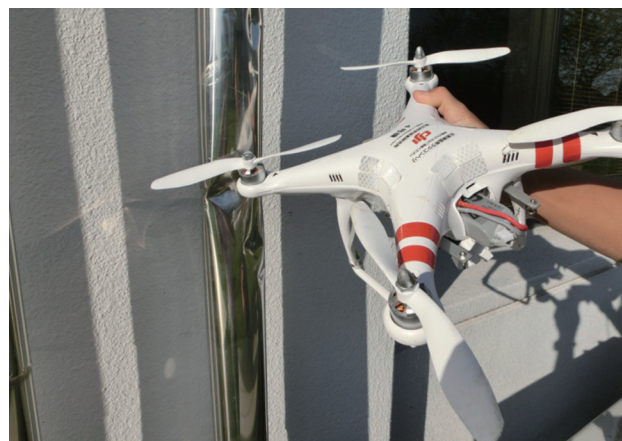
図 43 墜落による空調配管(直径 75 mm, ステンレス外皮)の損傷
