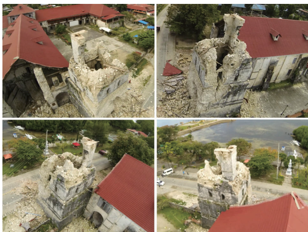
図 58 2013 年フィリピンボホール地震で倒壊したバクラヨン教会の鐘楼
