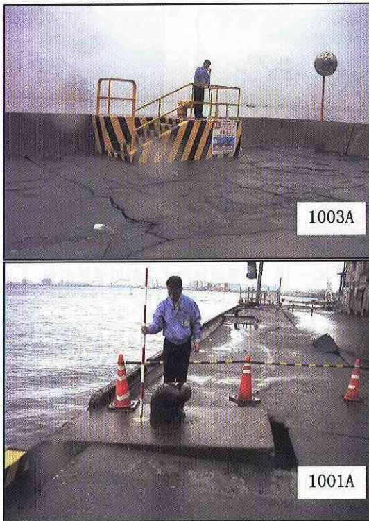
写真-3 街区基準点周辺の被害状況
