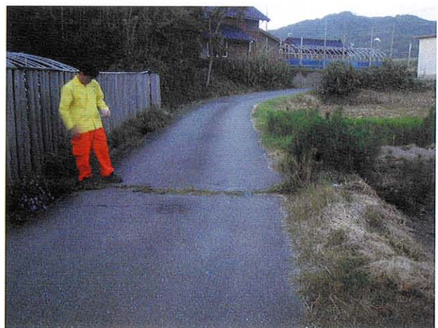
写真-4 図-11のBにおける道路上の亀裂
