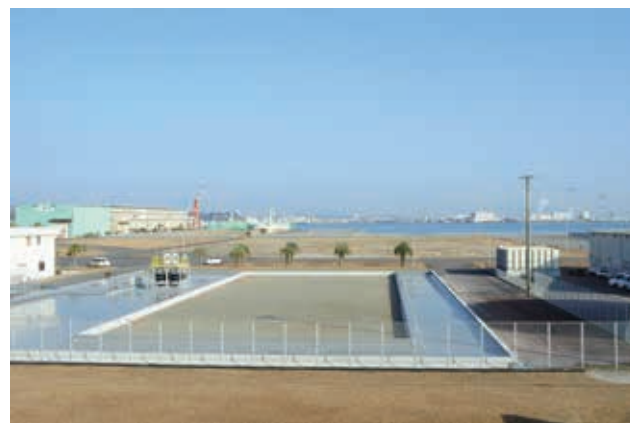
建設中の屋外大規模培養試験設備
